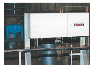
Armario de conmutación de servomuelle
