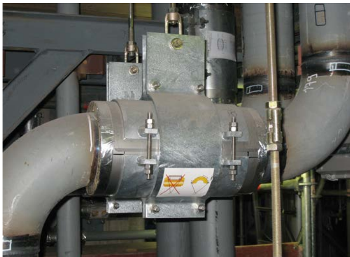
Suspensión con abrazaderas para tuberías criogénicas
