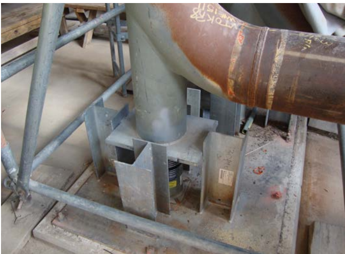
Stanchion tipo 58 para codos de tuberías utilizado como tope libre de momentos en la dirección X-Y con soportes de carga variable tipo 29
